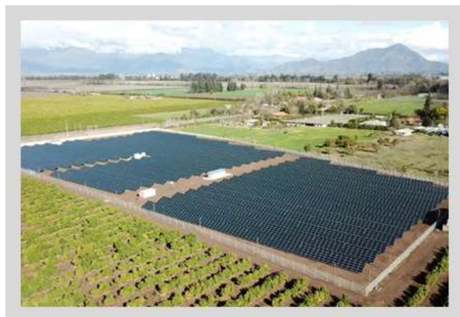
Instalación en Linderos (R. Metropolitana) – potencia 3,6 MWp
